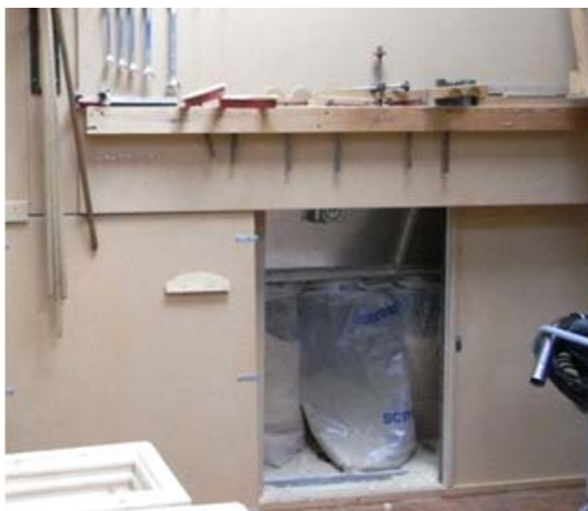
afzakfilterinstallatie met zakken
